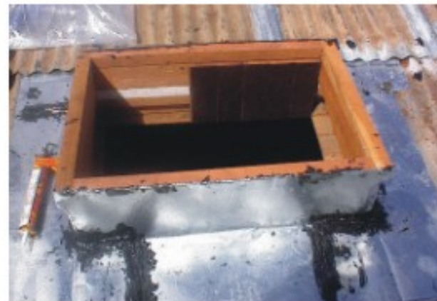
Caja de madera en techo de zinc. Juntas de lámina con brea.
