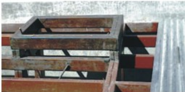
Caja de perlines en techo de zinc, antes de instalar flashing y techo.
